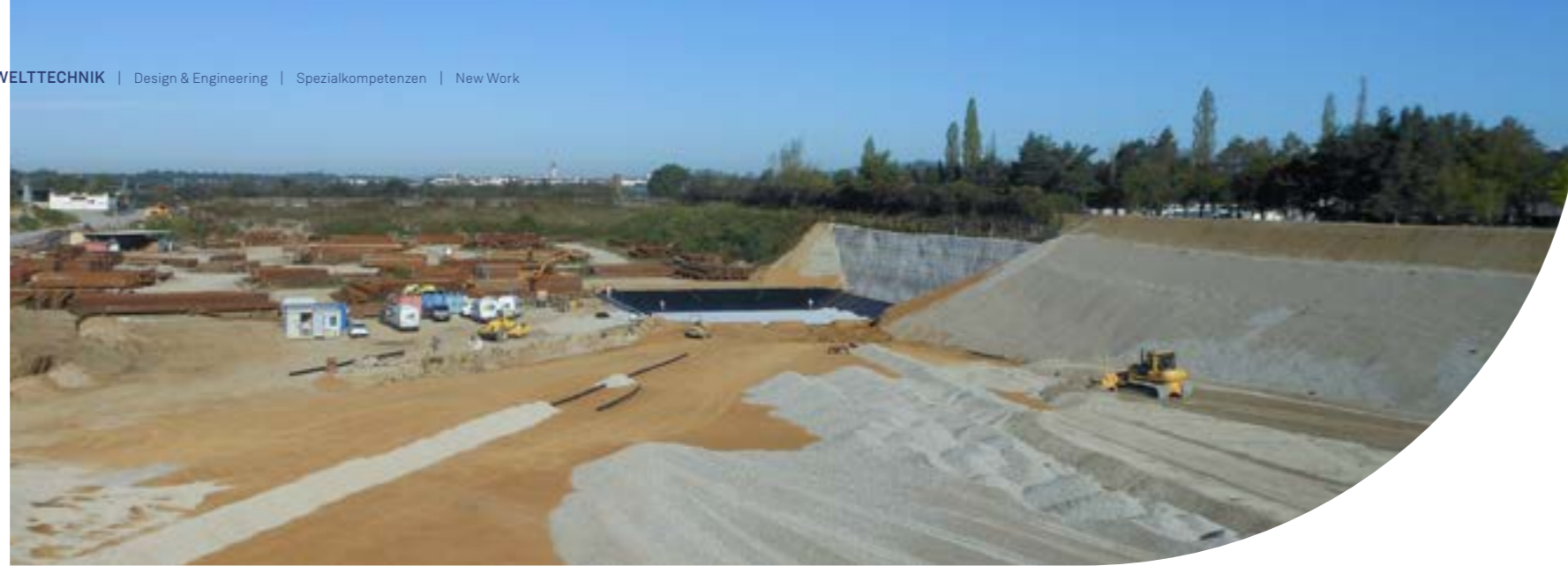
Baurestmassendeponie und Recyclinganlage Rems – Österreich Lagerung zahlreicher Abfallarten nach neuestem Stand der Technik
